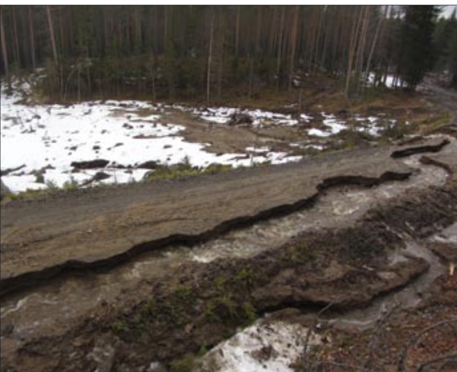
Store flomskader på vegnettet også i 2013.
